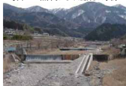
写真－３ 滞筋変化により閉塞した事例
