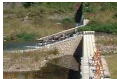
写真－２ 転石等により破損した事例
